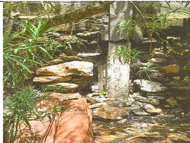
Foto 2: relleno del perímetro deteriorado
