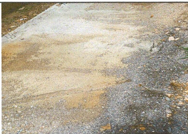
Foto 3: fosa septica en mal estado
