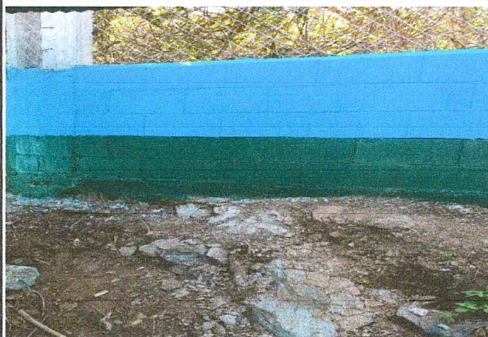
Foto 1: muro perimetral colapsando
